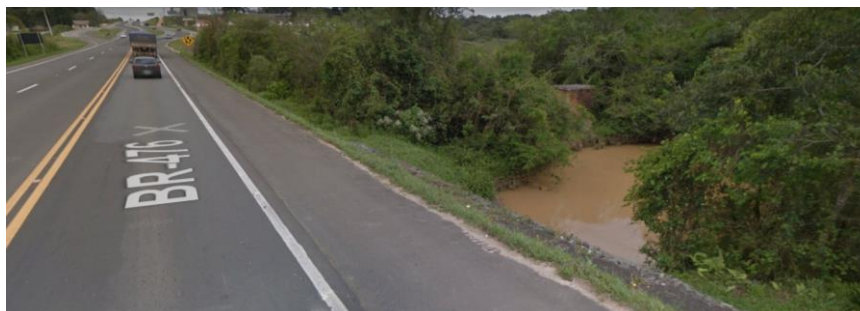
FIGURA 3 - FALTA DE BARRA DE CONTENÇÃO FONTE: GOOGLE MAPS (2018)
