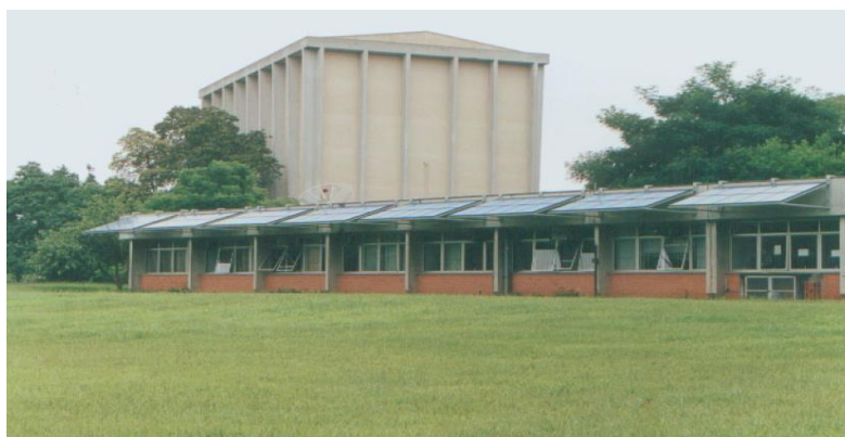
FIGURA 08: SISTEMA FOTOVOLTAICO DE 12,3 KWP, INSTALADO NO IEE-USP FONTE: RUTHER (2004)
