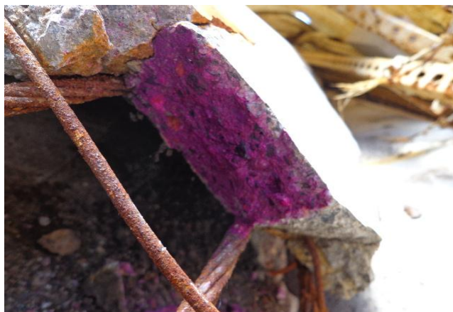
FIGURA 11 – VERIFICAÇÃO DA CARBONATAÇÃO E PH DO CONCRETO DA TELHA COLAPSADA FONTE: AUTORES (2016).
