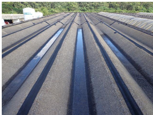
FIGURA 07 – TELHAS COM ACUMULOS DE ÁGUA. FONTE: AUTORES (2016).
