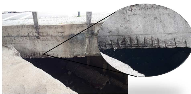
FIGURA 3: CONCRETO DETERIORADO E ARMADURA EXPOSTA COM CORROSÃO. FONTE: AS AUTORAS, 2019.
