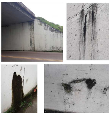
FIGURA 6: INFILTRAÇÕES NO VIADUTO. FONTE: AS AUTORAS, 2019.
