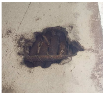
FIGURA 7: ARMADURAS EXPOSTAS E EM PROCESSO DE CORROSÃO. FONTE: AS AUTORAS, 2019.
