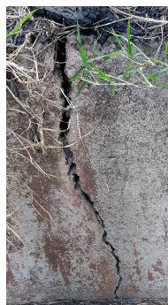
FIGURA 5: RACHADURA NO ENCONTRO DO VIADUTO. FONTE: AS AUTORAS, 2019.
