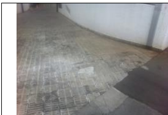
Foto 07 - Manifestações patológicas de trincas
