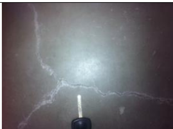
Foto 05 - Manifestações patológicas de trincas
