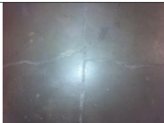
Foto 06 - Manifestações patológicas de trincas
