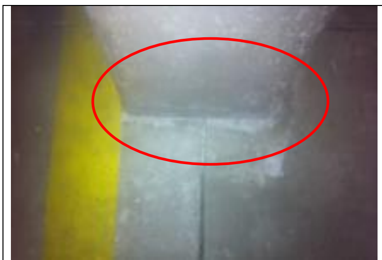
Foto 09 – Encontro entre piso e pilar pré-fabricado, sem junta
