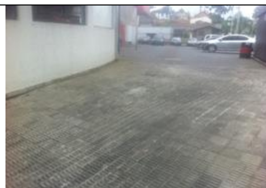
Foto 08 - Manifestações patológicas de trincas
