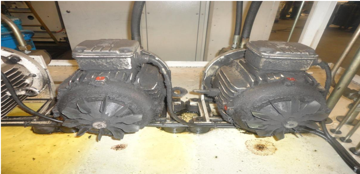
FIGURA 5 - BOMBAS HIDRÁULICAS DA MÁQUINA NA PRIMEIRA INSPEÇÃO FONTE: EMPRESA ESTUDADA
